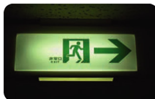
正常な表示板
